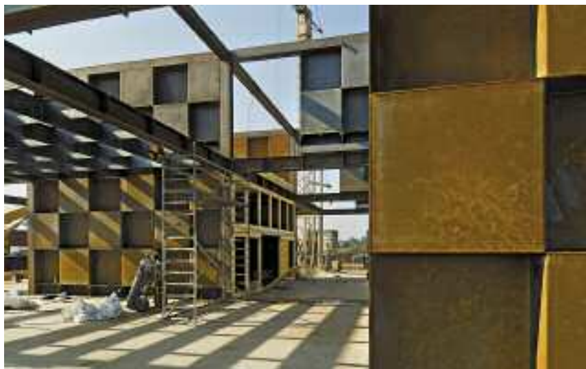
La structure de base du projet repose sur une trame carrée pouvant se développer de la même manière dans toutes les directions.
