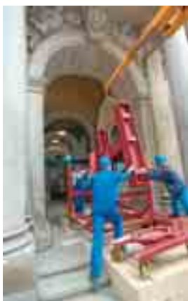
Der Stahlbau wurde im Werk vorgefertigt, in handlichen Teilen angeliefert und mit Rücksicht auf den laufenden Bürobetrieb ohne Lärm- und Staubemissionen montiert.
